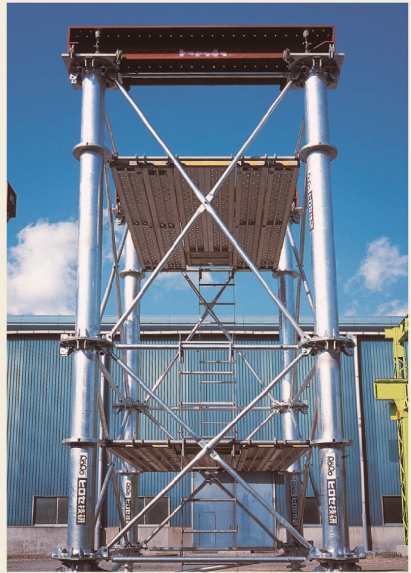
● 垂直タラップと蓋付き中段足場
